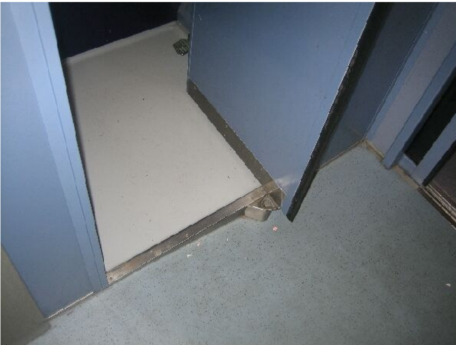
Bild 20 Zugang zu den Sanitarräumen über schmale Tür mit Schwelle
