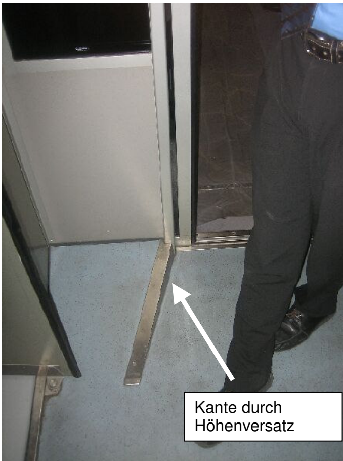
Bild 9 Gefährliche Kanten in den Gängen (Umknick-Gefahr)
