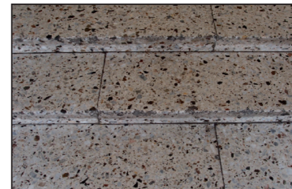
Abbildung 37: Negativbeispiel – fehlende Stufenmarkierung im Treppenhaus
