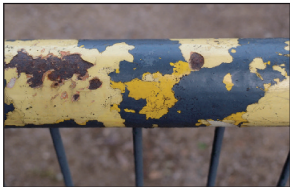
Abbildung 45: Negativbeispiel – abgeblätterter Lack und Rost an Metallabspernung
