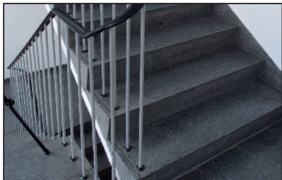
Abbildung 39: Negativbeispiel – fehlende Stufenmarkierung, kontrastarmer Handlauf
