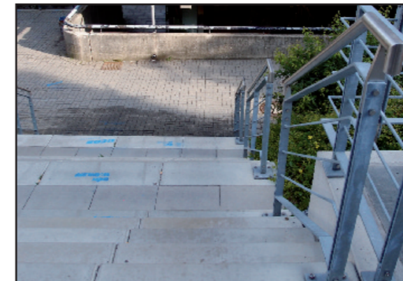
Abbildung 41: Negativbeispiel – fehlende Stufenmarkierung, Betonstufen im Außenbereich
